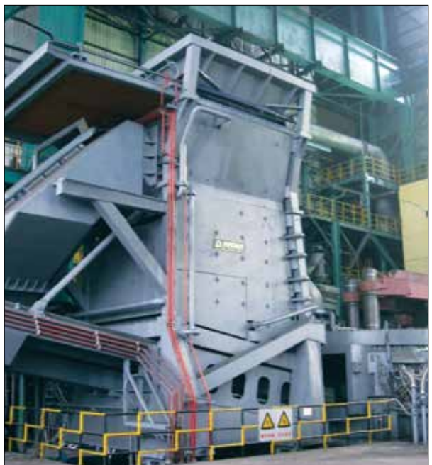
شکل ۳- تجهیزات پیش گرم قراضه در مجاورت کوره قوس الکتریکی
