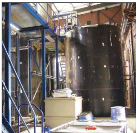
یک سیستم صنعتی پیاده سازی شده برای تصفیه انتخابی نیترات
